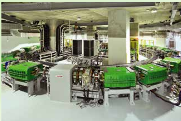
加速器室(シンクロトロン)
