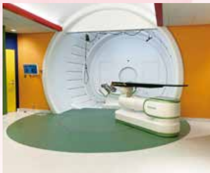
東日本重粒子センター 回転ガントリー照射室
